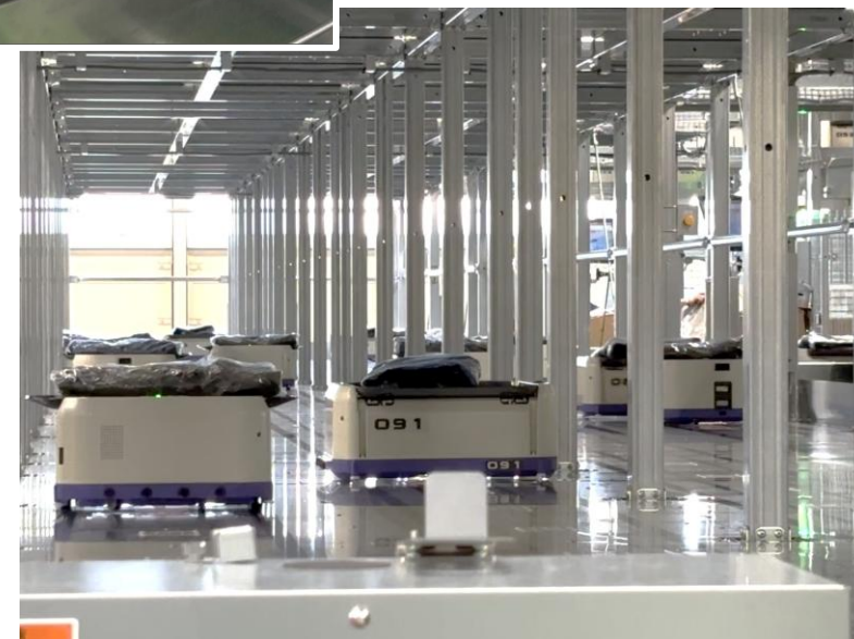
ソーター設備
